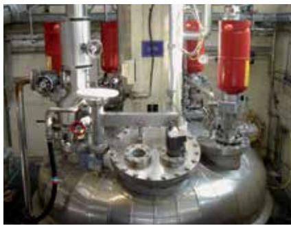
Oben angebrachtes Explosionsunterdrückungssystem mit abwärts gerichteten Löschmittelaustritt.
