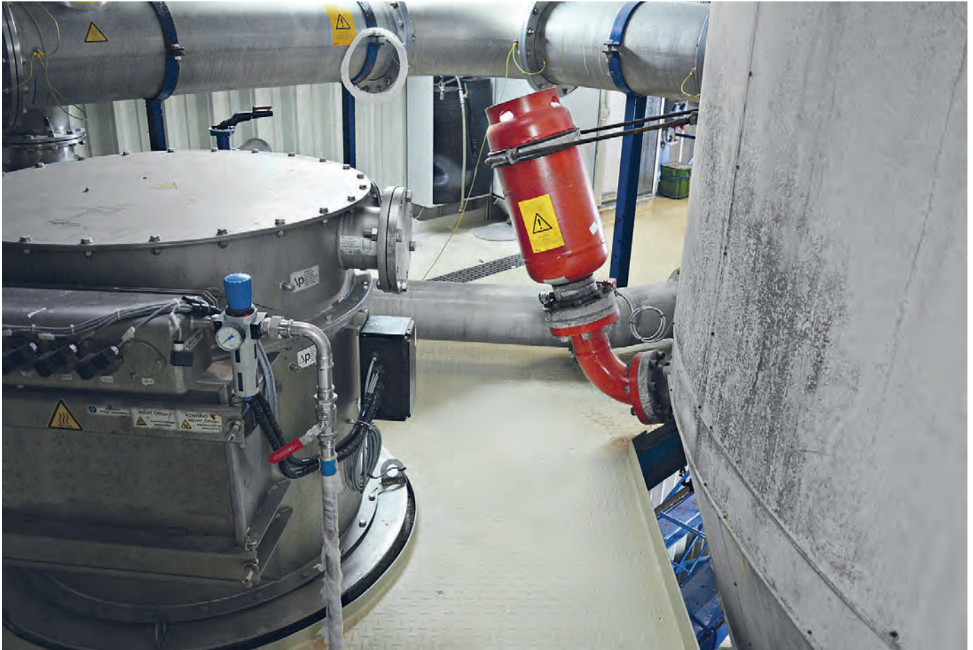
Anlage der inprotec AG mit Explosionsunterdrückungssystem der IEP Technologies GmbH
